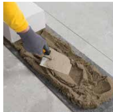
Minimální vrstva zakládací malty má být cca 20 mm (10–40 mm) pod celou plochou tvárnice.
